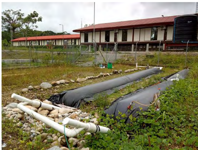
Figura 1 | Biodigestores tubulares en serie de la planta piloto para tratamiento de aguas residuales en la Universidad Regional Amazónica Ikiam (Ecuador).
